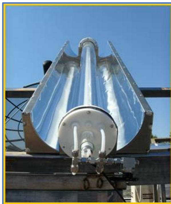
Sistema detoxificación de aire con energía solar. CIEMAT.
