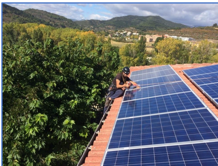
Instalación de autoconsumo
