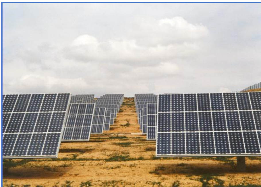
Instalación fotovoltaica conectada a Red
