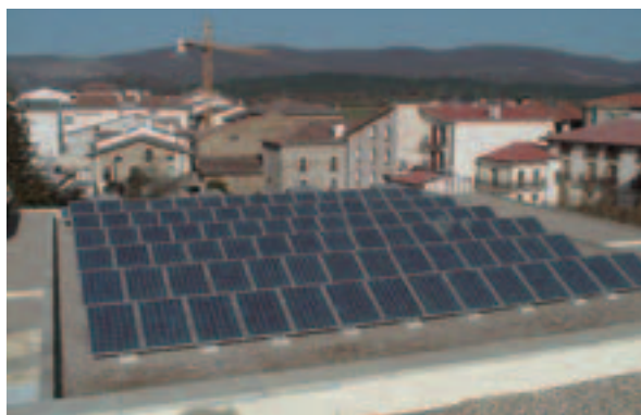
Foto 2. Instalación conectada a red.
