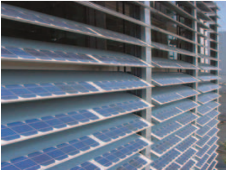
Foto 10. Instalación fotovoltaica integrada en lamas.
