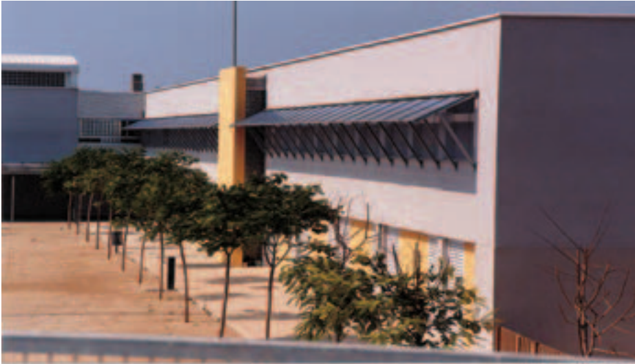
Foto 11. Instalación fotovoltaica integrada en parasoles.
