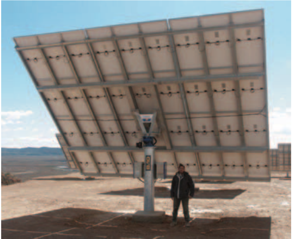
Foto 7. Instalación fotovoltaica sobre seguidor solar.
