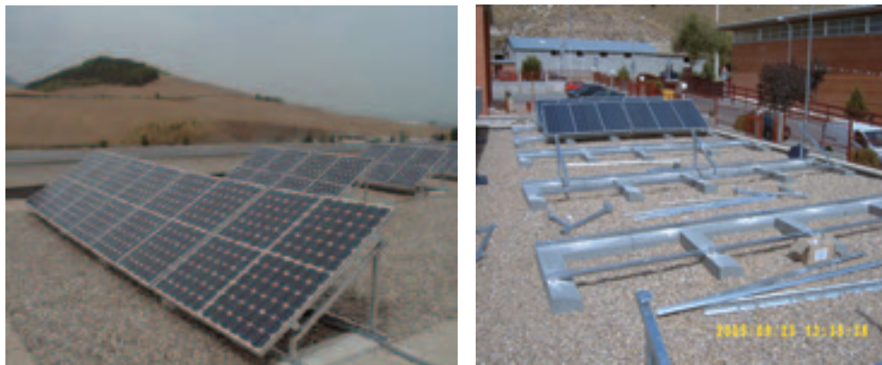
Foto 6. Sistema fotovoltaico sobre tejado plano no perforable.
