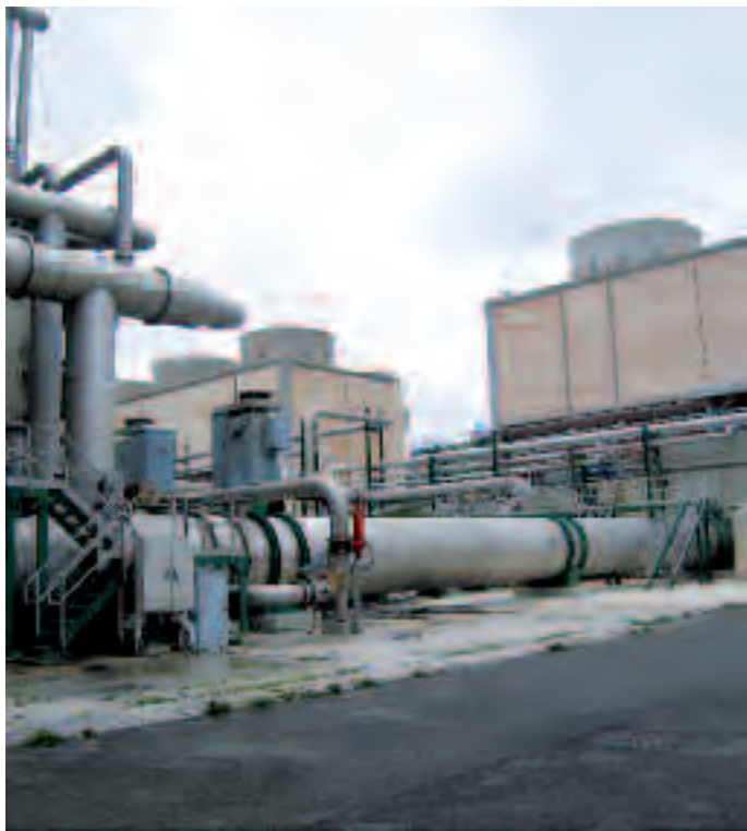
Central geotérmica actual de Larderello (Italia)
