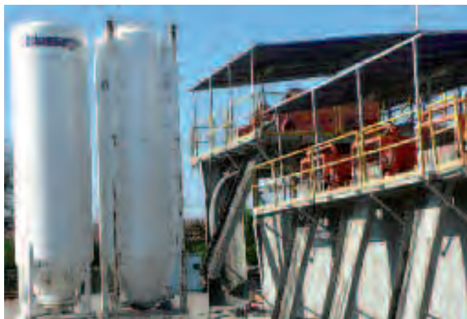
Uso geotérmico en planta cementera (Alemania)
